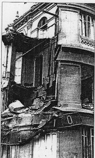
Efecto de un bombardeo sobre un edificio.
