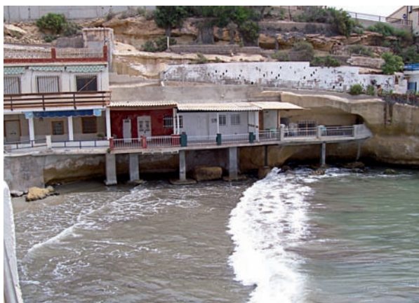
Ocupación de zonas acantiladas. San Juan de los Terreros (Pulpi). Año 2006. Fuente: A. Viciano.
