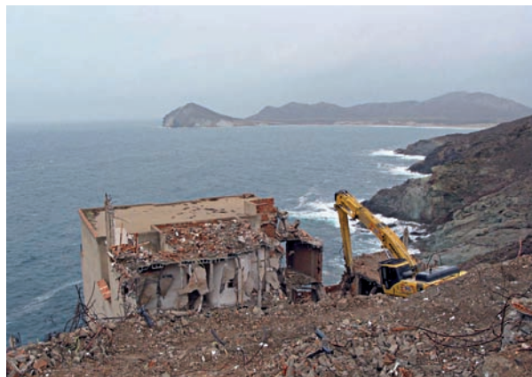
Demolición de edificio ilegal en San José, reconvertido en mirador. Año, 2006. Fuente: TRAGSA. En agradecimiento y memoria de Josefina Huertas.
